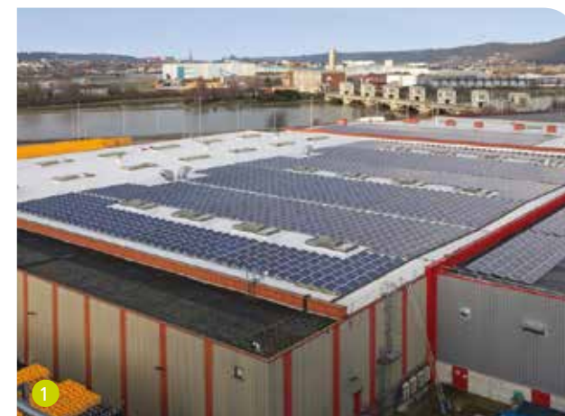
1 Het dak van de Jupiler fabriek kon worden gerenoveerd vooraleer de zonnepanelen werden geplaatst.
